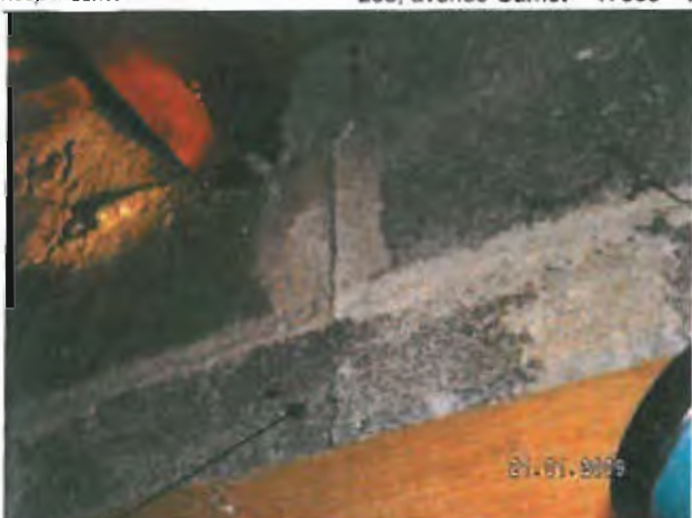
Fissure montant jusqu'à la panne
