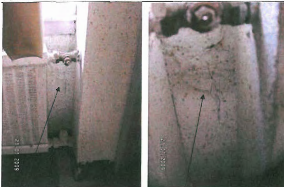
Fissure verticale de l'allège à côté du poteau BA
