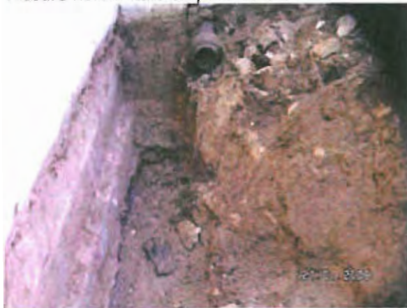
Mise à jour de la semelle. Absence de semelle correctement dimensionnée sous le poteau.
