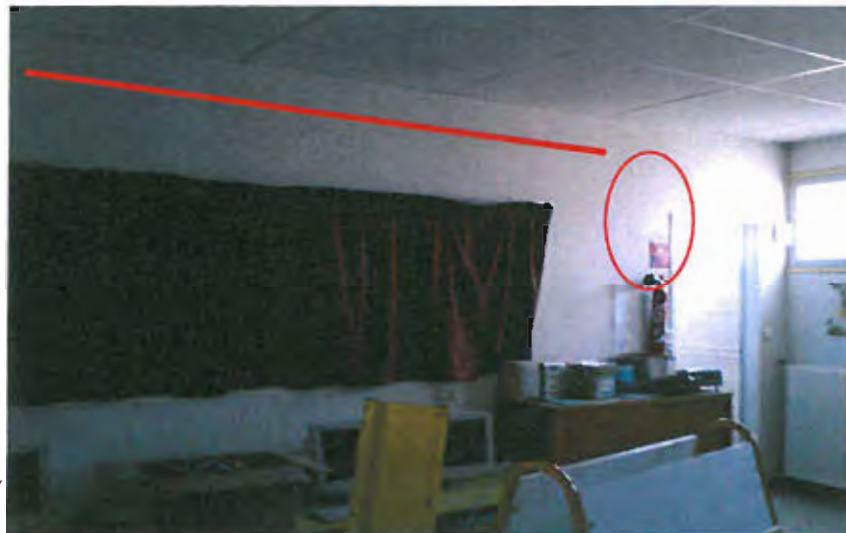
Pic 4 : grande fissure horizontale dans la maçonnerie et au niveau de l'appui du linteau de porte sur mur de refend de la zone aggravée
