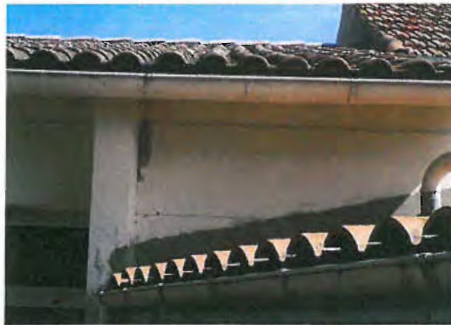
Pic 5 : Zoom sur fissure côté extérieur façade Sud de l'aile Nord
