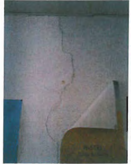
Pic 1 : zoom sur fissure
